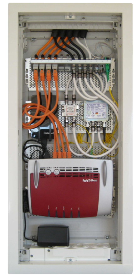
Medienverteiler in den Wohnungen
